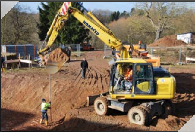
März Start für die Bauarbeiten zur neuen Wohnanlage enercase direkt auf dem Universitäts-Campus mit 84 Apartments in modularer Holz-Hybrid Bauweise.
